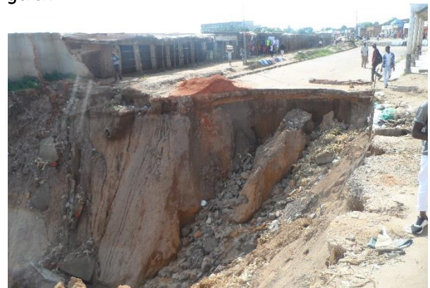
la rue 's'effondre/ de straat is ingestort
